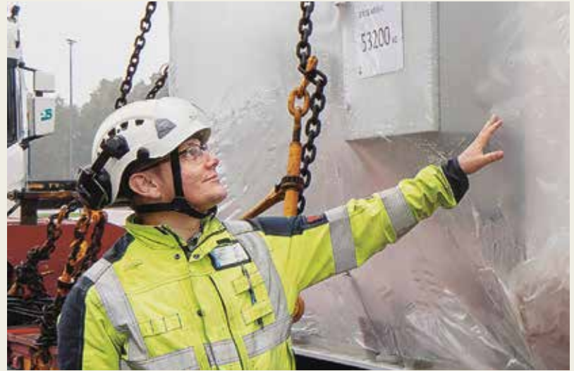
Raskas paketti. 53 200 kg, lukee Carl-Johan Nylund, alueverkon käyttö-päällikkö ja uuden sähköaseman rakennushankkeen hankejohtaja. Kun muuntajaan on saatu öljyt ja muut, paino nousee yli 58 tonniin.
