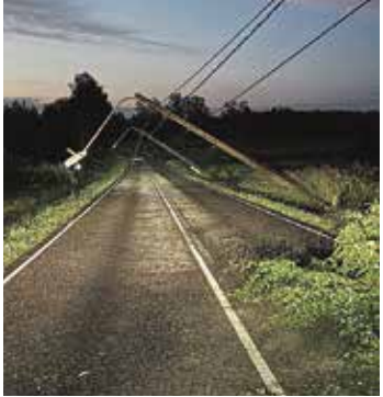
Elstolpar knäckta över vägen in mot Nedervetil.
