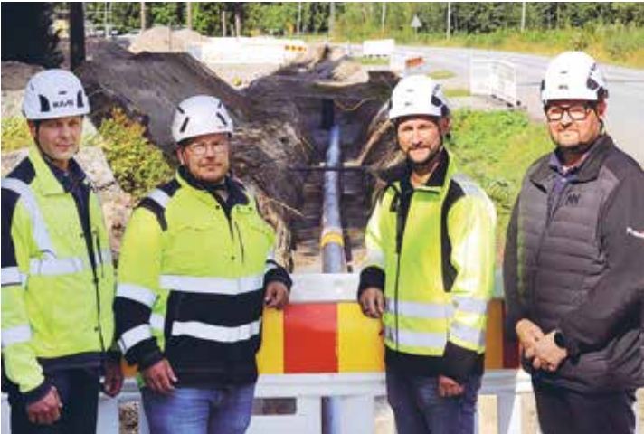
Herrfors fjärrvärmeanslutning nummer 1000 blev Prewels fabrik på Bottenviksvägen i Jakobstad. På bilden Ronny Forsman och Jonas Asplund från Herrfors och Kim Nordlund och Kriste Koski från Prewel.
